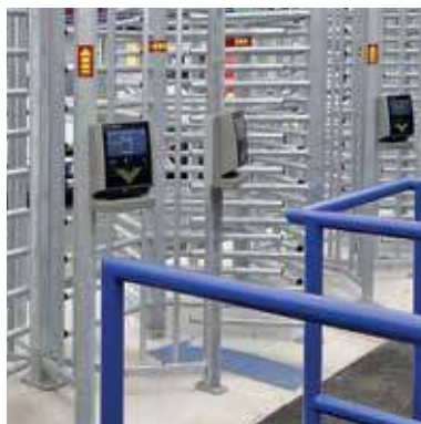
REA::TICKET – терминал билетной системы / СКД
