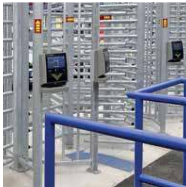
REA::TICKET – терминал билетной системы / СКД
